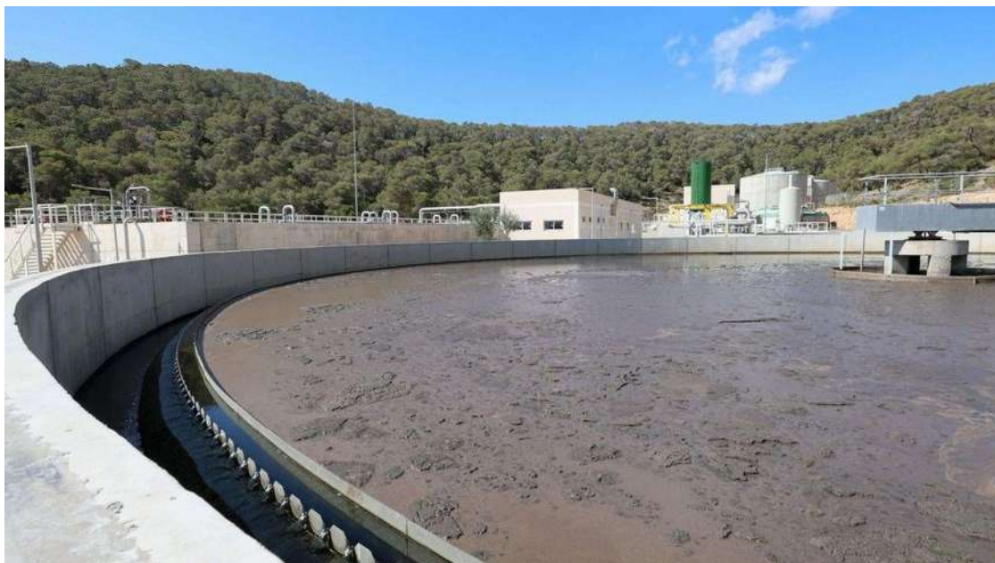
Depuradora de aguas residuales de sa Coma, en Ibiza. / JUAN ANTONIO RIERA
