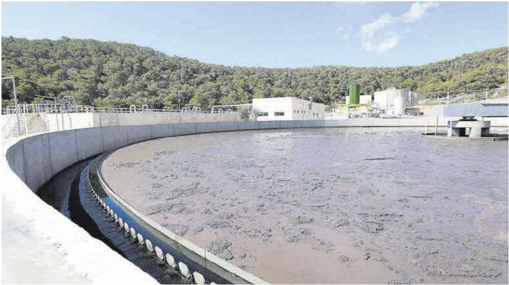
Depuradora de aguas residuales de sa Coma, en Eivissa.
